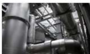
プラント配管
